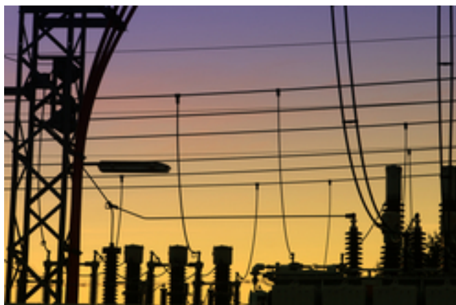
Stromleitungen. Foto: BDI/fotolia (jeancliac)
